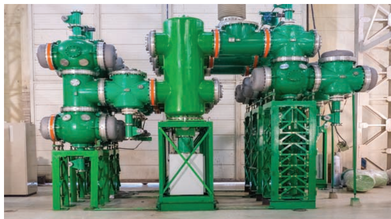
BHEL make 400 kV GIS
